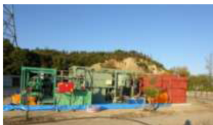
■ 実績例：重金属類 複合汚染 10m 3 /時 広島県
